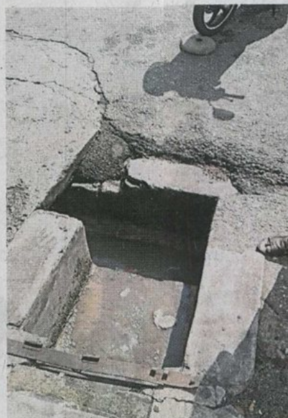
▲铁沟盖被撬走，只留下一条牢钉在石沟上的铁条。
